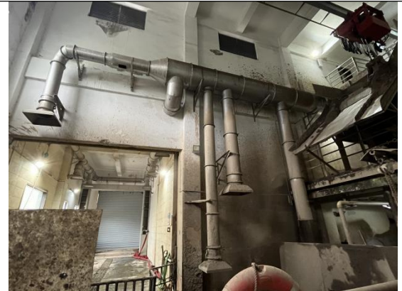
通沟污泥站臭气抽风管道
